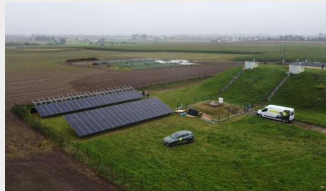
Instalacja fotowoltaiczna na ujęciu wody w Brusach
